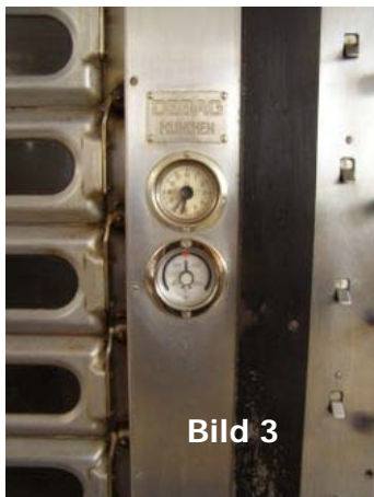
Steuerung/ Temperaturanzeige Ofen
